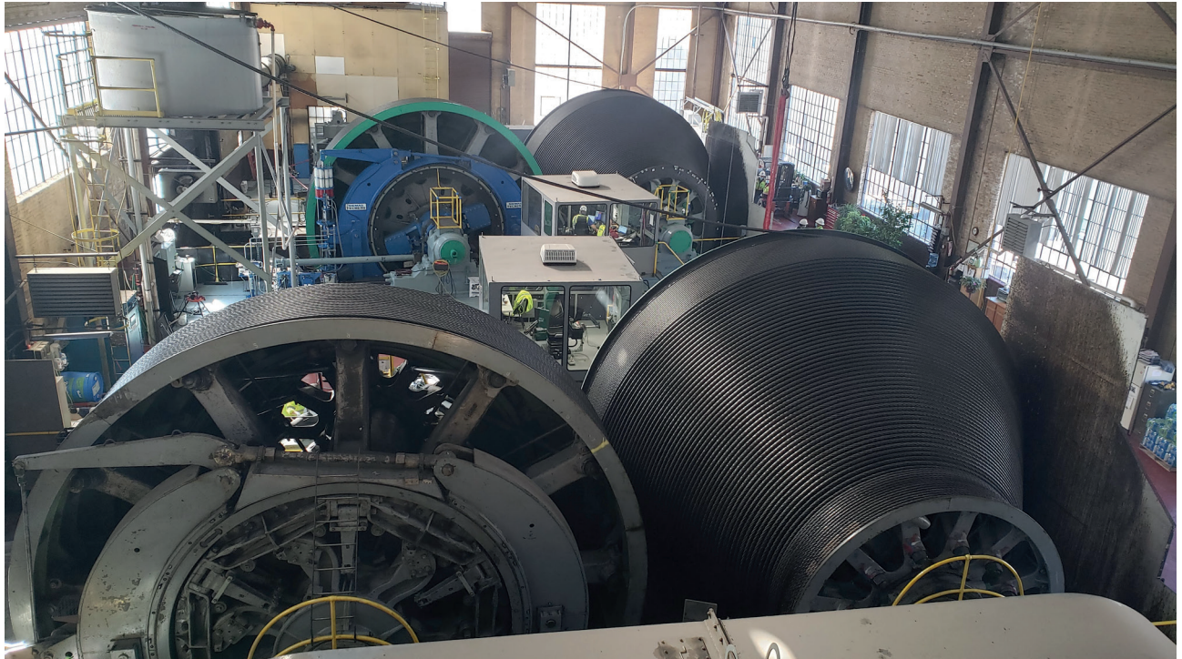
Abb. 4: Blick in den Maschinenraum des Ross-Schachts mit den beiden Trommelfördermaschinen – im Vordergrund die beiden Trommeln der Produktionsmaschine, im Hintergrund die Trommeln der Seilfahrtmaschine, dazwischen die beiden Maschinenleitstände in ihren Maschinistenkabinen.
