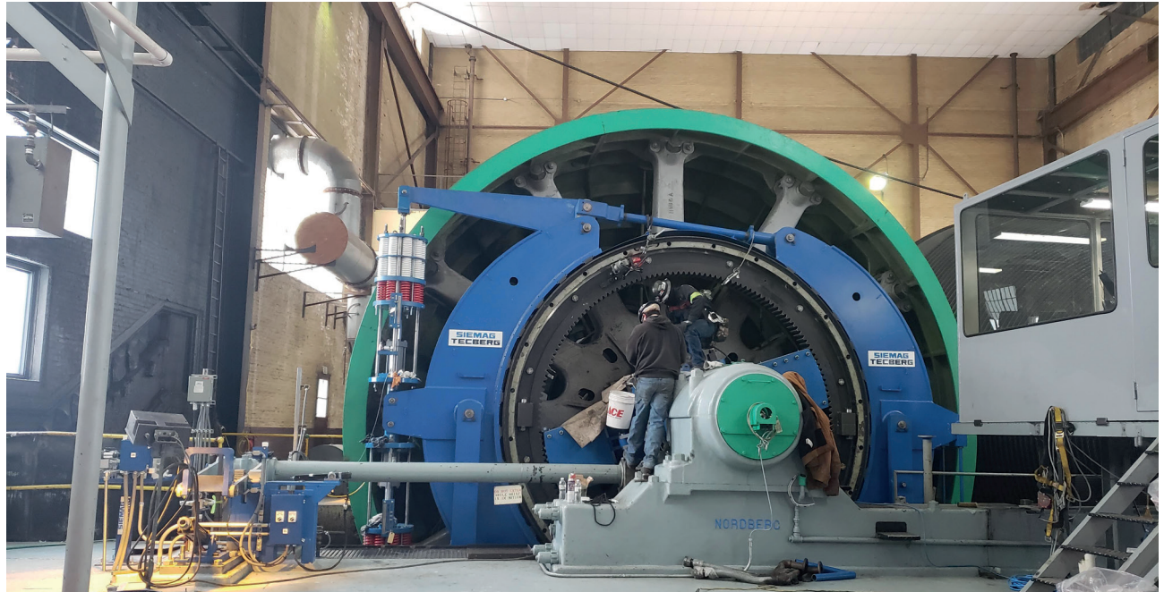
Abb. 5: Blick auf die Seilfahrt-Trommelmaschine mit neuer Kupplung und neuem Bremssystem.
